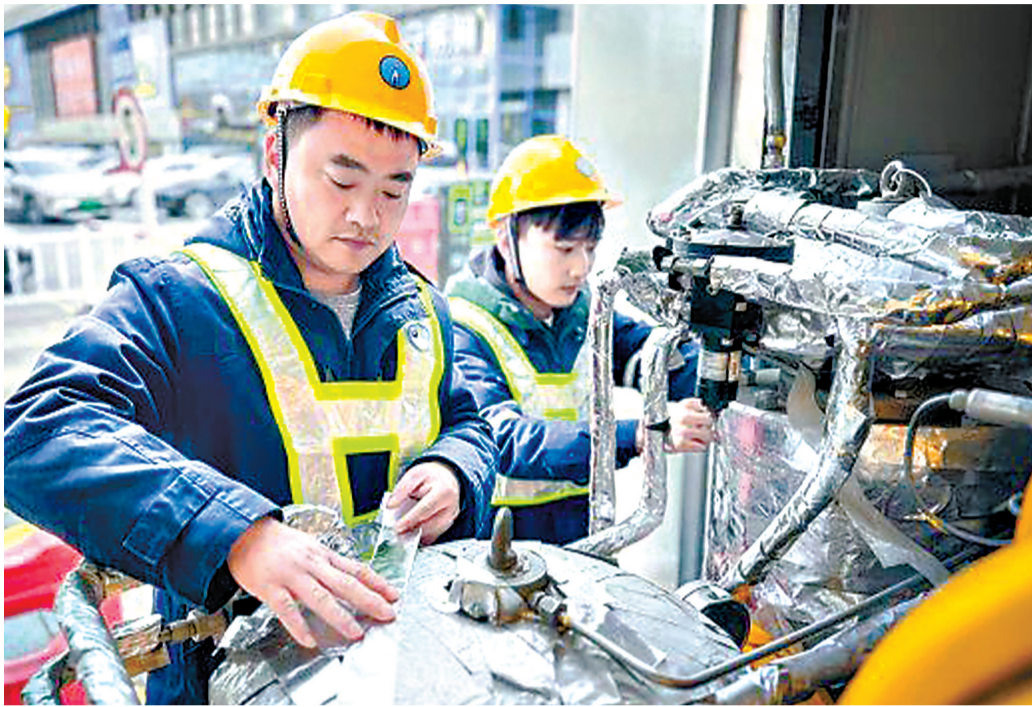
↑市燃气集团工作人员检查调压设备保温层。
