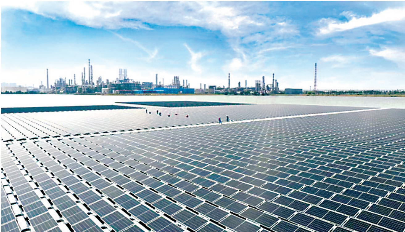
青岛炼化全海水环境漂浮式光伏项目。
